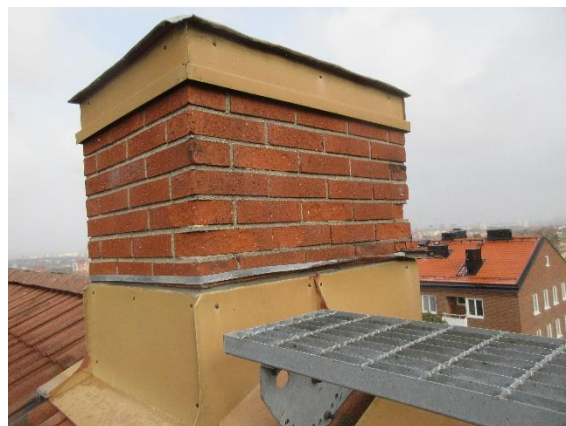
Skorsten med skador på teglet
