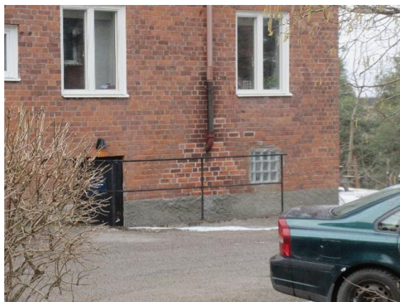
Stupröret läcker vatten
