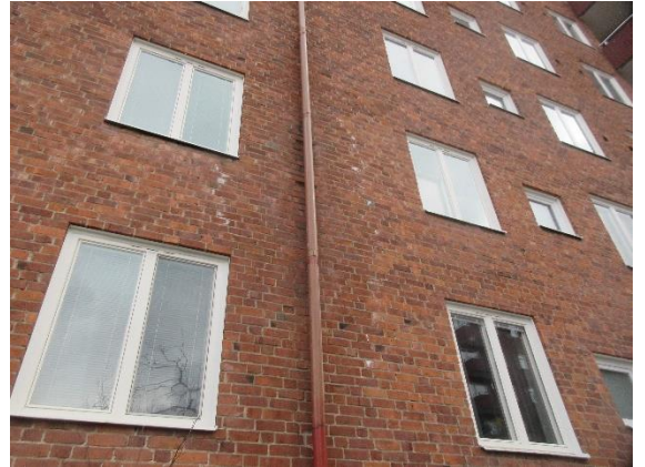
Teglet fuktas upp från vatten från stupröret.
