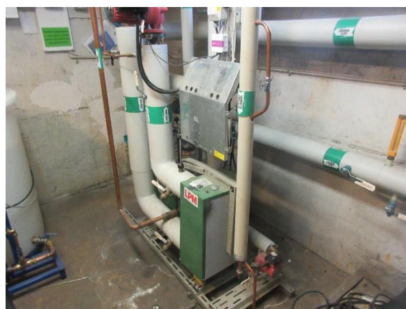
Undercentral för fjärrvärme från 1999
