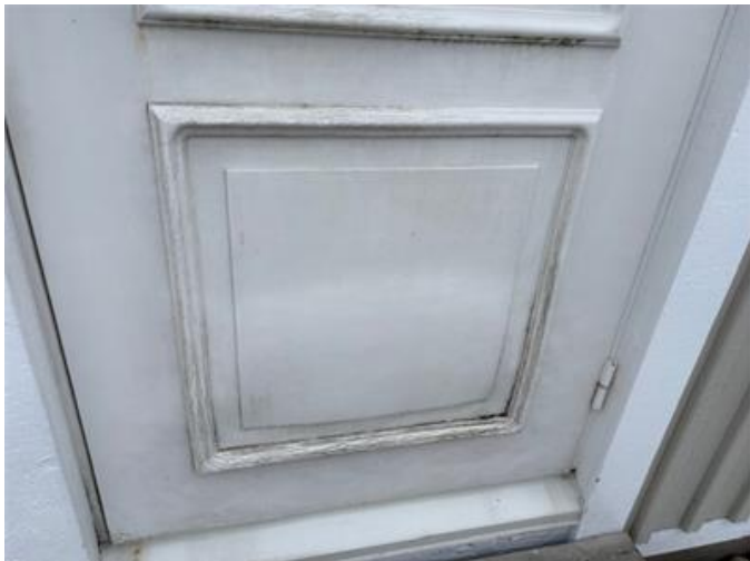
Bilden visar entrédörren till tvättstugan där formförändringar förekommer.
