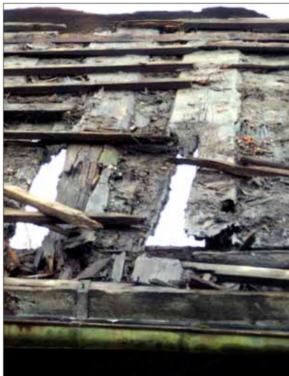
10 Rötskador på underlagstaket på takfallet mot Långgatan, 20080303 (D08-654).
