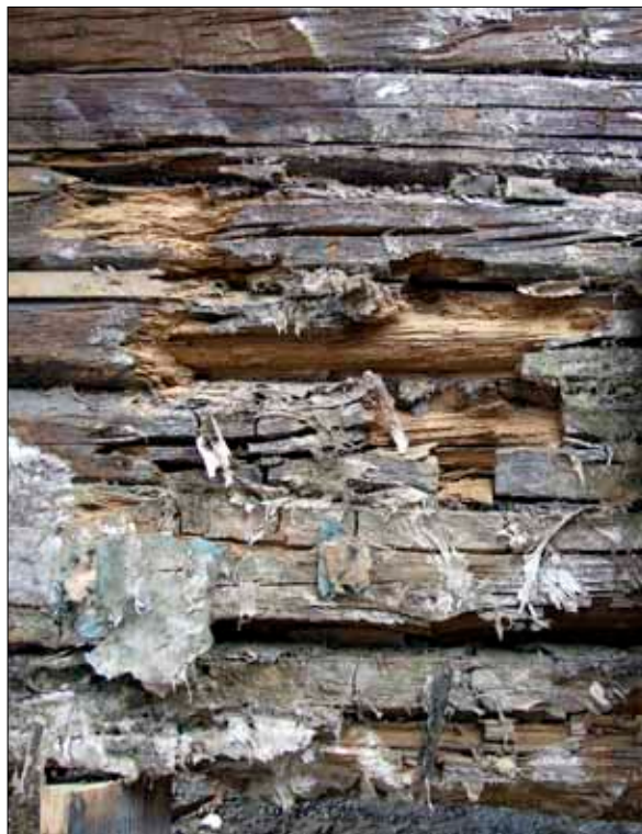
9 Hussvampsangripiet parti av byggnadens stomme, 20080303 (D08-652).
