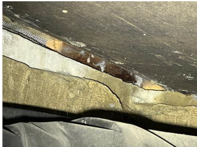
Bilden visar fuktgenomträngning i ytterhörn i krypgrunden.
