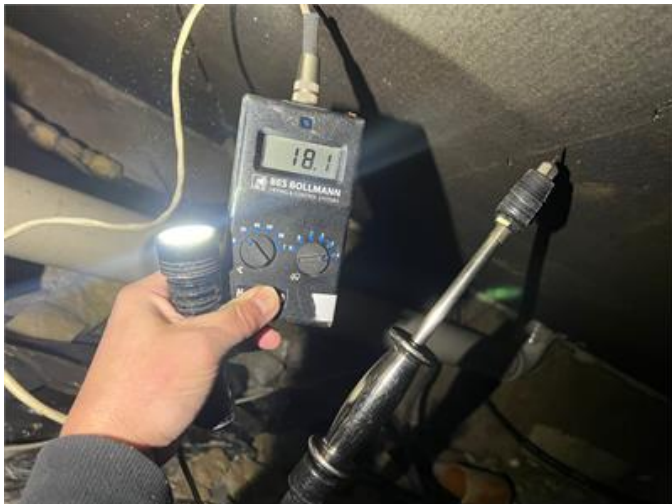
Fuktkvoten uppmättes till 18% i krypgrunden.
