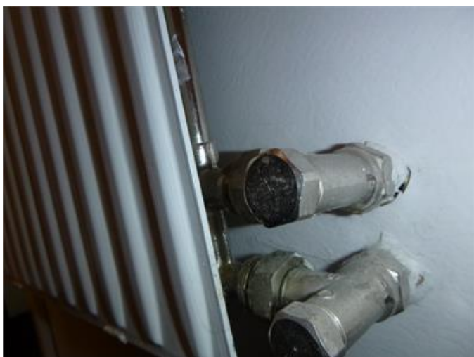
Otäta rör genomföringar i badrummet nära duschzonen
