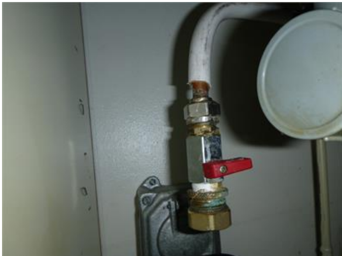
Läckage i rörkoppling i kökets diskskåp
