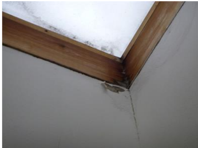
Fuktrelaterade skador kring takfönster
