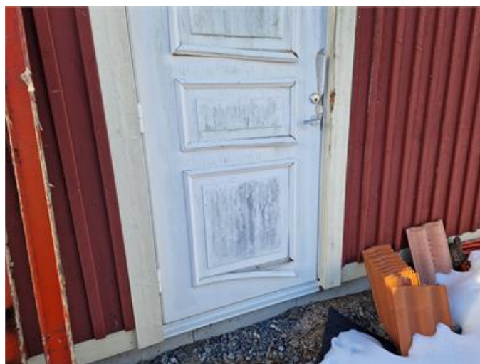
Garage: Igenbyggd entrédörr har behov av underhåll/Åtgärder.
