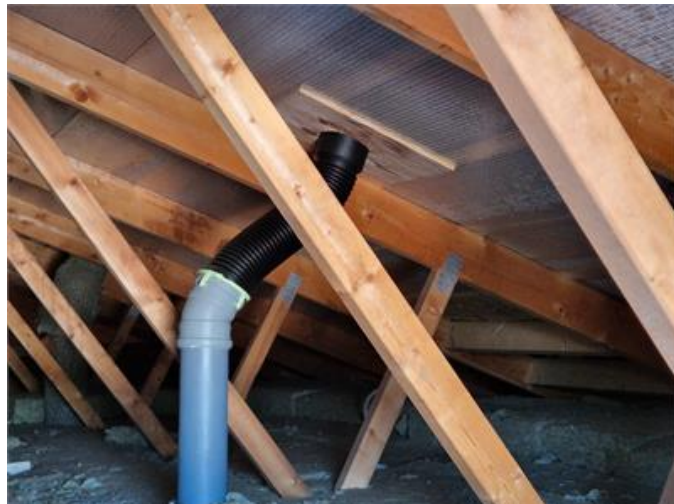
Vind Tillbyggnad: Fuktfäckar noterades kring rör genomföring.
