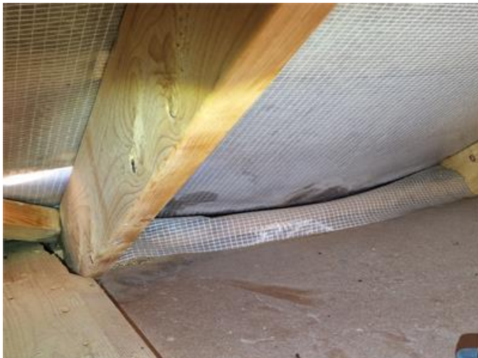
Vind: Fläckar noterades lokalt ovan plast,
