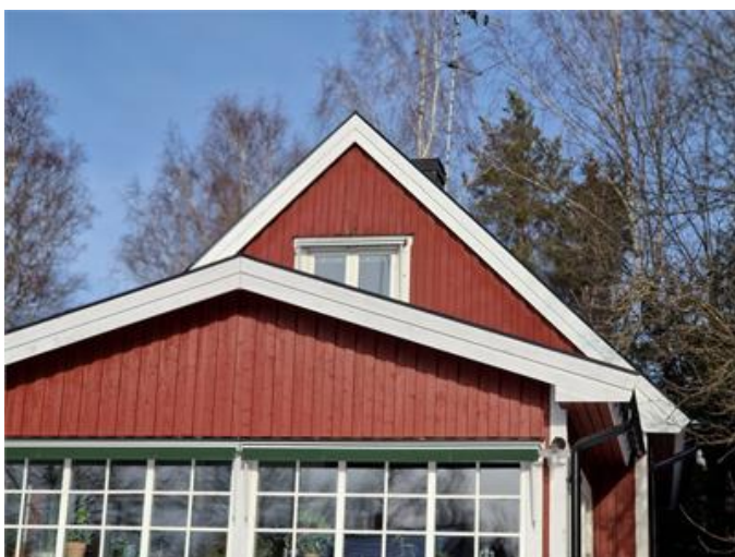
Fasad och Sockel: Rötskador förekommer i fasadpanel.
