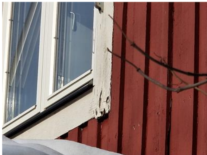
Fönster och Dörrar: Rötskador i förekommer i fönsterfoder.
