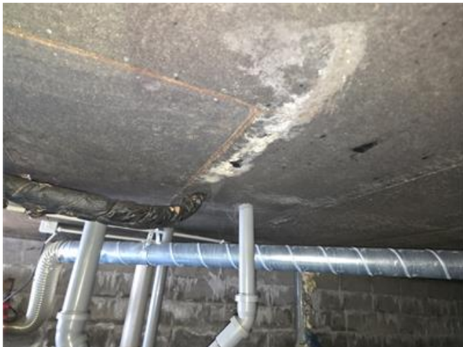
Bilden visar missfärgning i på blindbotten.
