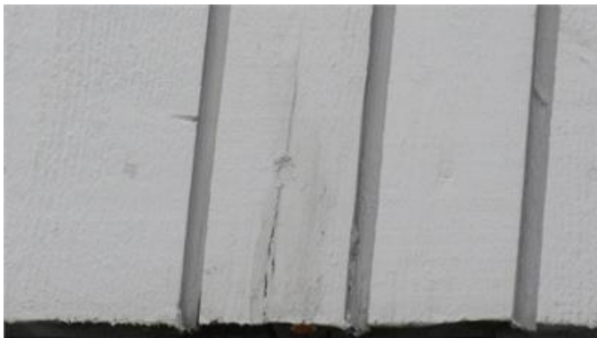
Torrsprickor i fasad.
