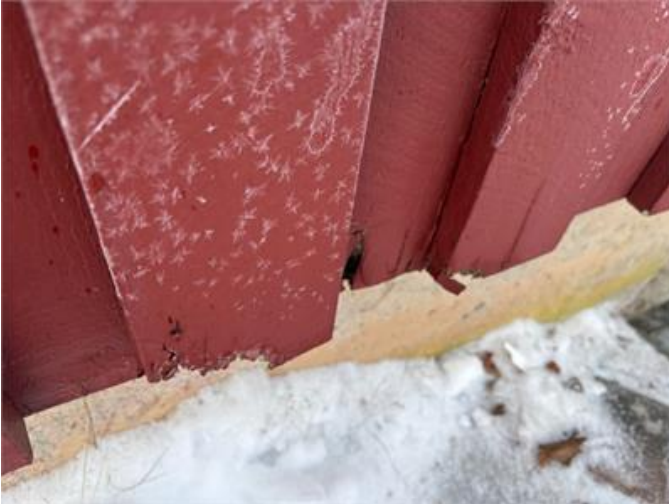
Bilden visar exempel på rötskador i fasadpanelen.
