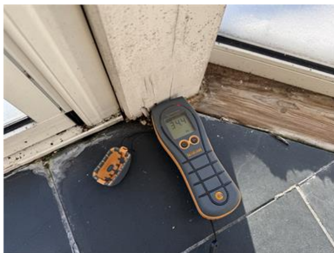
Förhöjda fuktvärden i stolpar i det större uterummet.
