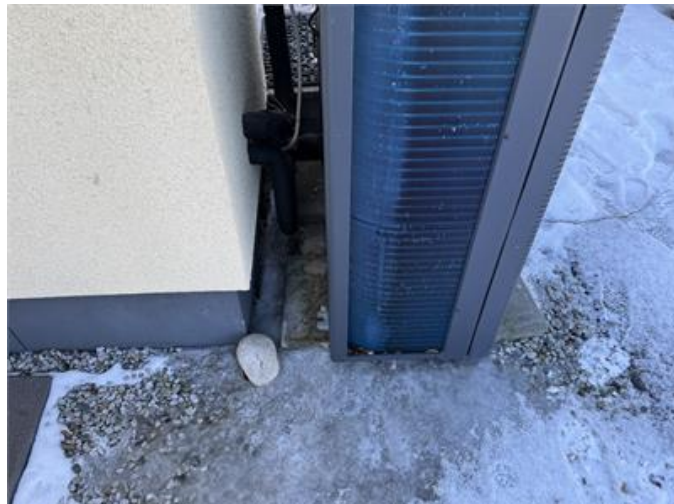
Kondensvattnet från luftvärmepumpens utedel leds inte bort från huset.
