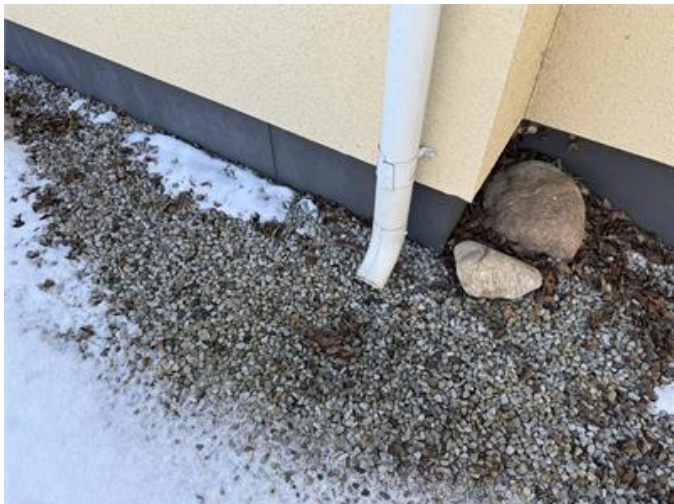
Stuprör ej anslutna till markledningar.
