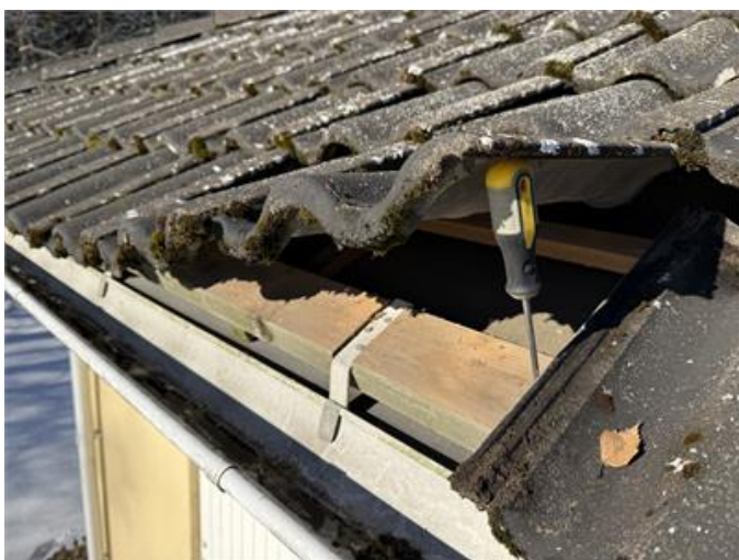
Nedre raderna takpannor inte fixerade (garage).
