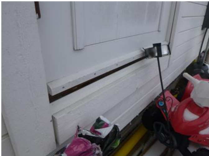
Fotplåt saknas vid dörr
