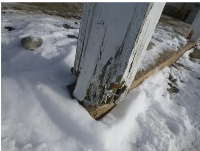
Rötskador i carportens stolpe
