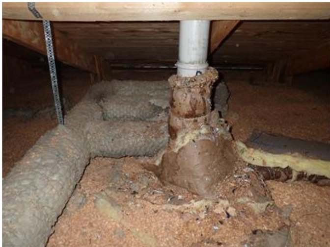
Fuktpåverkad isolering på vind.
