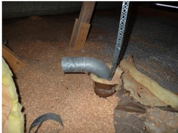
Ventilationsrör ovan sovrum 3 som inte är i bruk.
