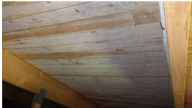
Mikrobiell påväxt på vinden
