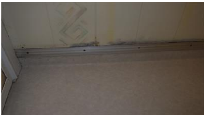
Missfärgning på nederkant duschvägg
