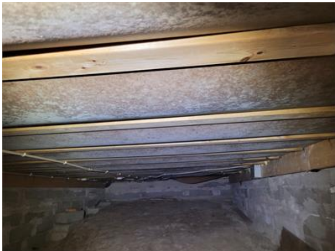
Mikrobiell påväxt på blindbotten.
