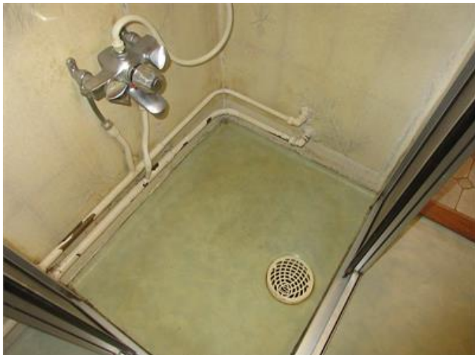
Rör genomföringar i vägg i dusch
