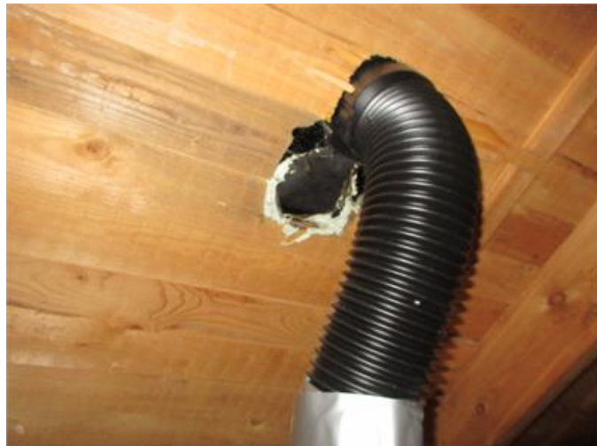
Bristfällig tätning i tak runt avloppsluftare
