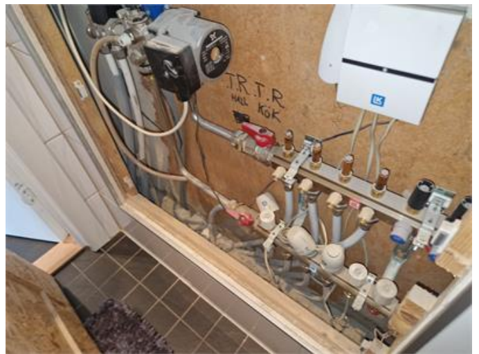
Fuktskydd saknas i kopplingsskåp.
