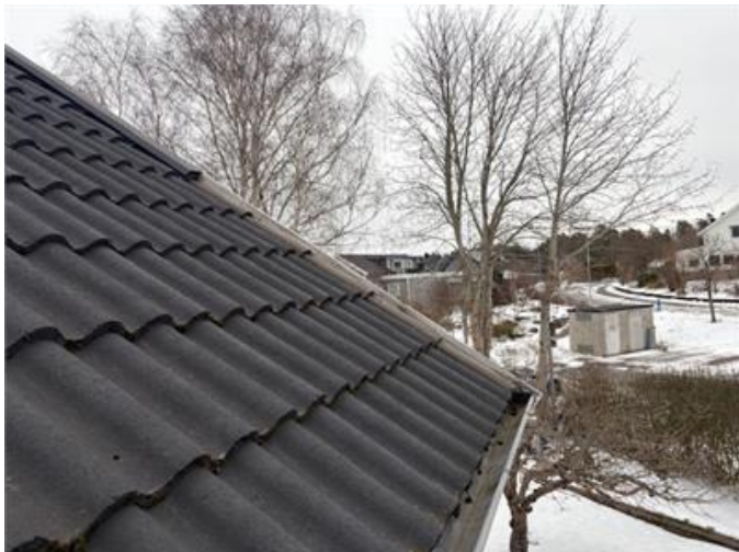
Bilden visar del av tak där vindskiveplåt saknas.
