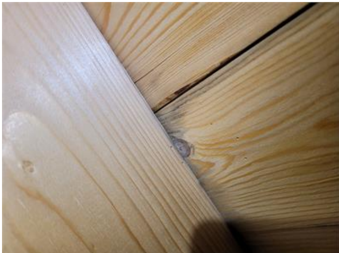
Fuktfläck/missfärgning på underlagstak.
