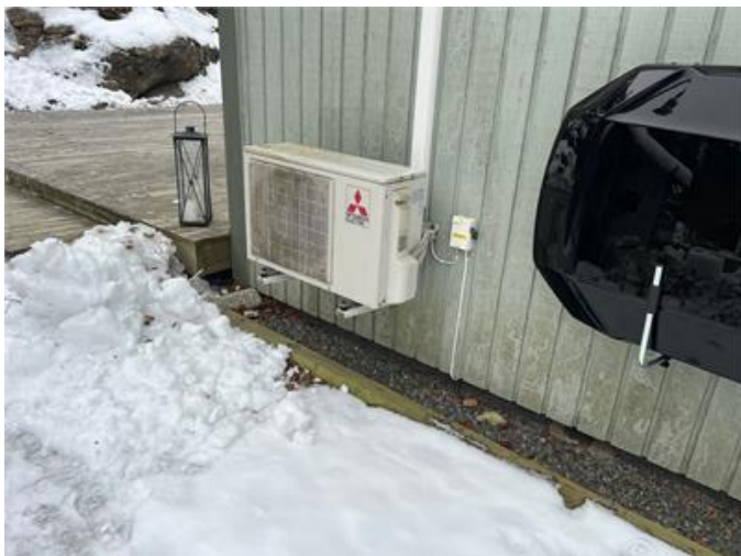
Värmepump släpper ut kondensvatten intill husliv.
