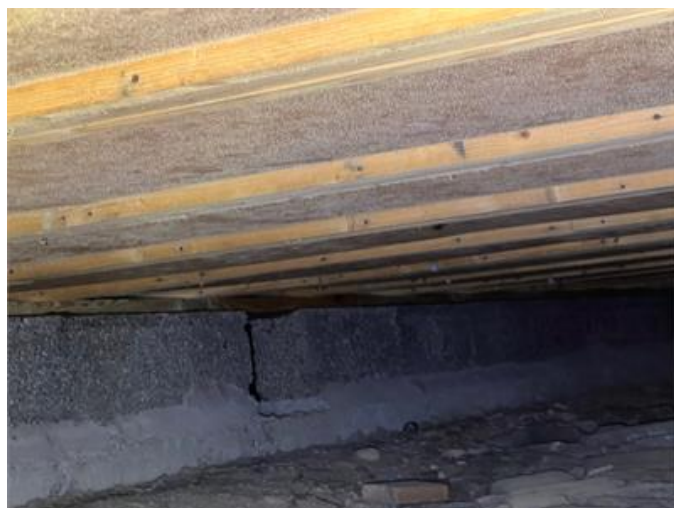
Mikrobiell påväxt i blindbotten i krypgrunden.
