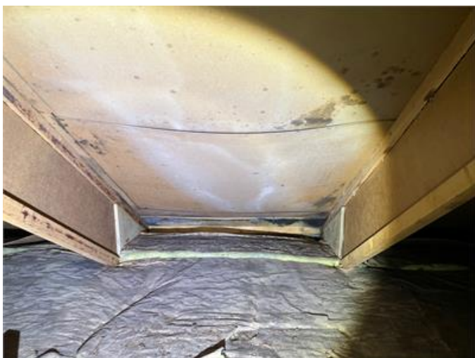
Exempel på fuktfläckar/mikrobiell påväxt i underlagstaket i vindsutrymmet.
