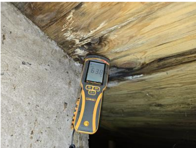
Nockvind: Fuktfläckar/missfärgningar runt murstock med förhöjda värden.
