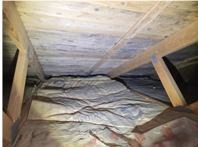
Nockvind: Mikrobiell påväxt samt isolering som ligger an mot underlagstak.
