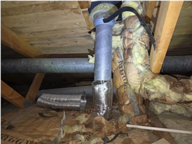
Nockvind: Imkanal ej korrekt ansluten samt saknar isolering.
