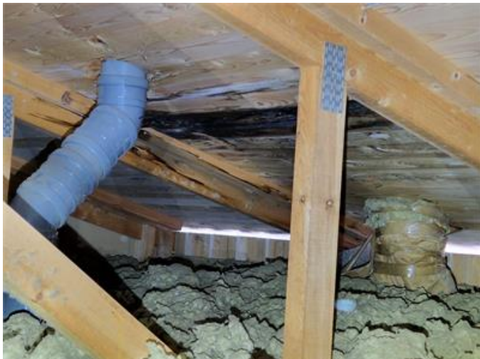
Vind: Fuktgenomslag noterades i undelagstak
