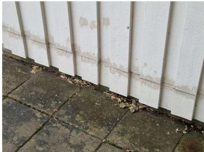
Garage: Fasadpanel olämpligt skarvad.
