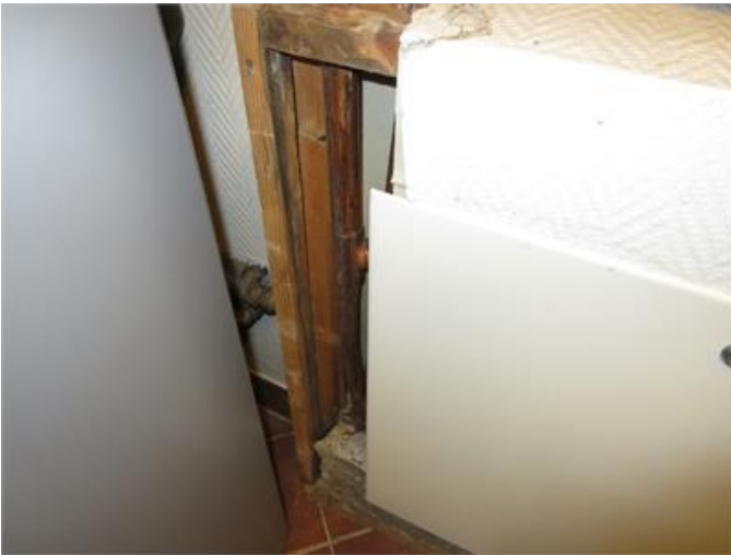
Bild visar demonterade gipsskivor på rörlits i tvättstuga
