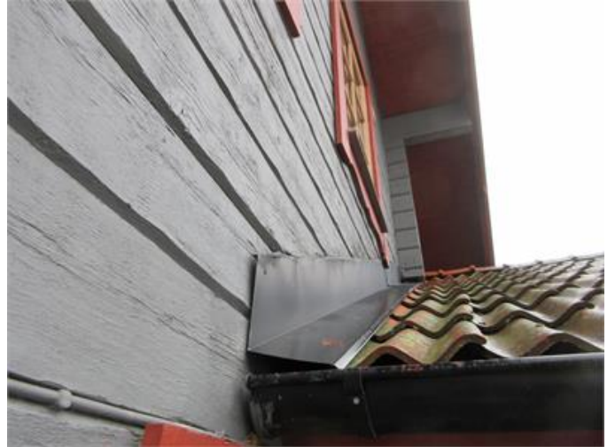
Vattplåt på tak som släpper från fasad
