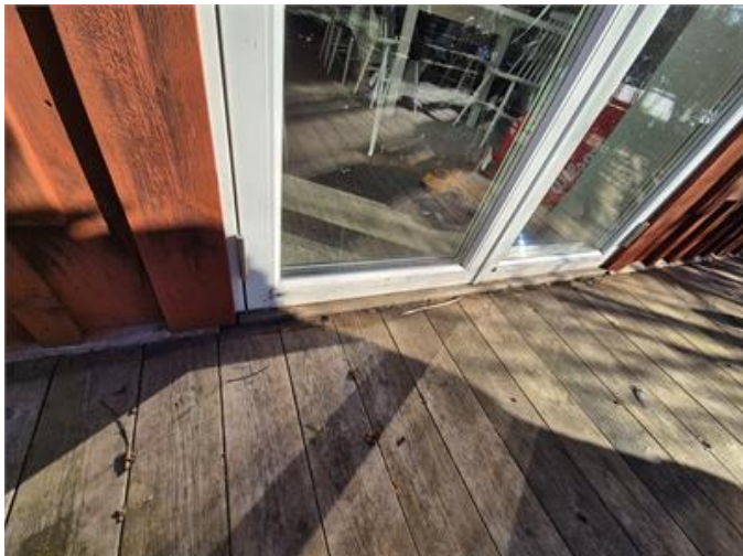
Tröskelplåt saknas under altandörr.
