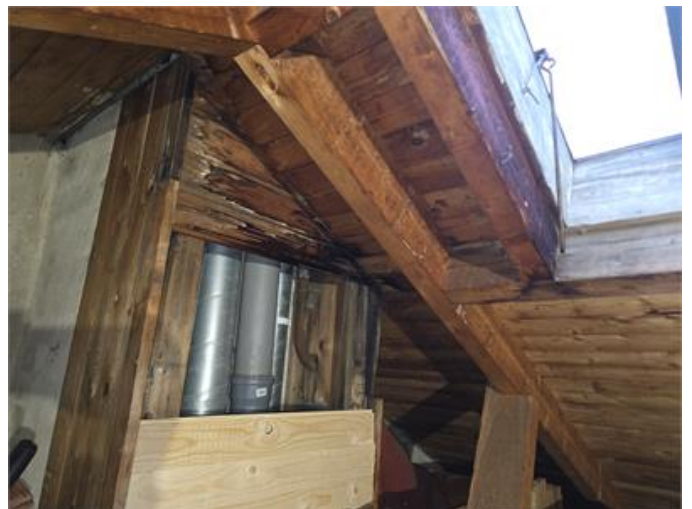
Bilden visar fuktiga partier vid/i anslutning till luckan.
