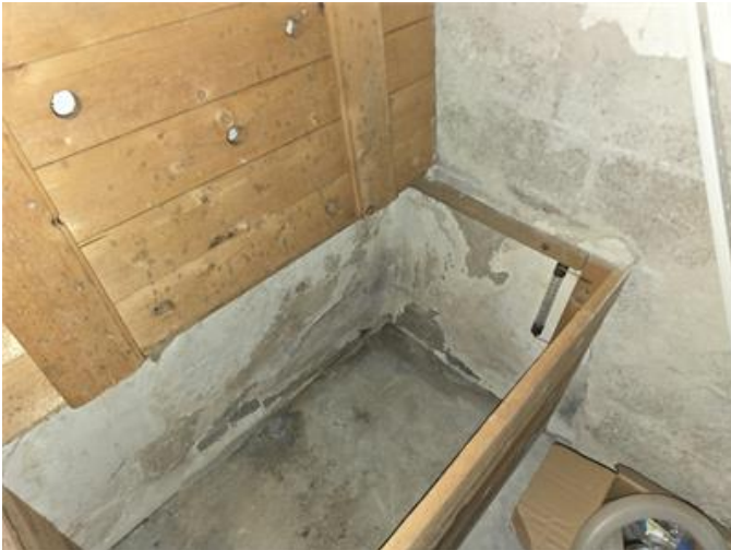
Exempel på putssläpp på yttervägg i källare.
