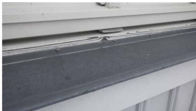
Fönster med målning/underhållsbehov
