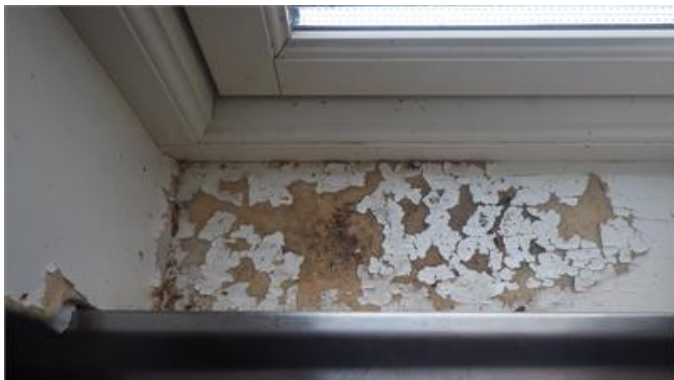
Missfärgning och formförändrar fönsterbänk vid diskbänken
