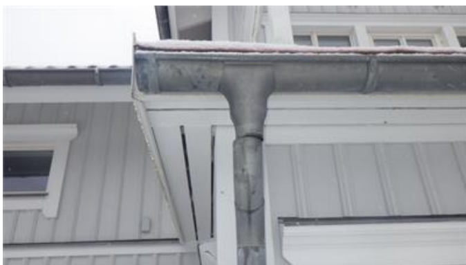
Stuprör som glidit isär
