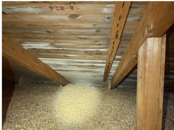
Bild visar mikrobiell påväxt mot underlagstak.
