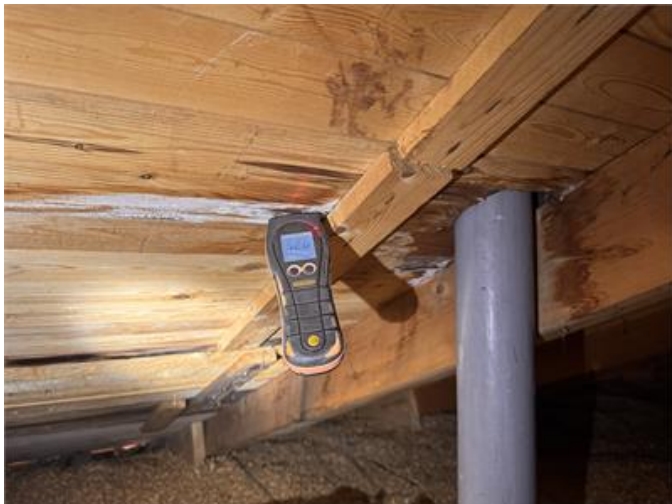
Bild visar läckage vid genomföring.
