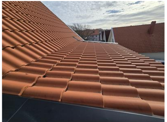
Tak: Takbeklädning på kupor ej anpassad för taklutningen.
