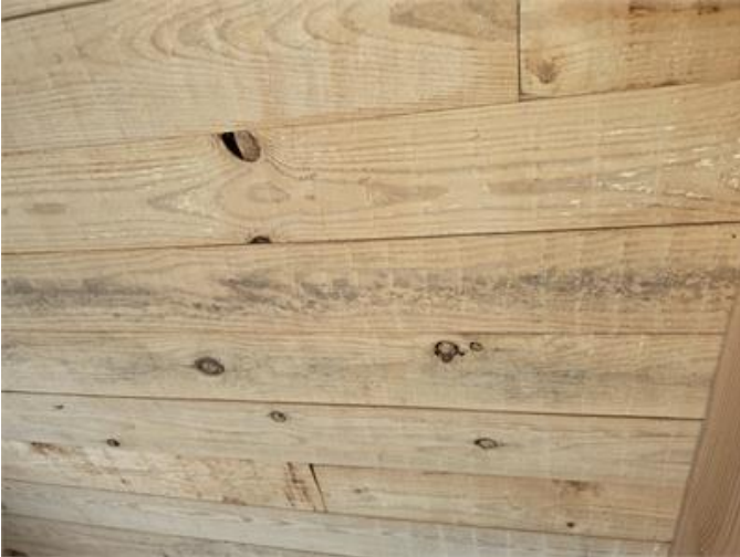
Nockvind: Mindre mikrobiell påväxt noteras på underlagstak.
