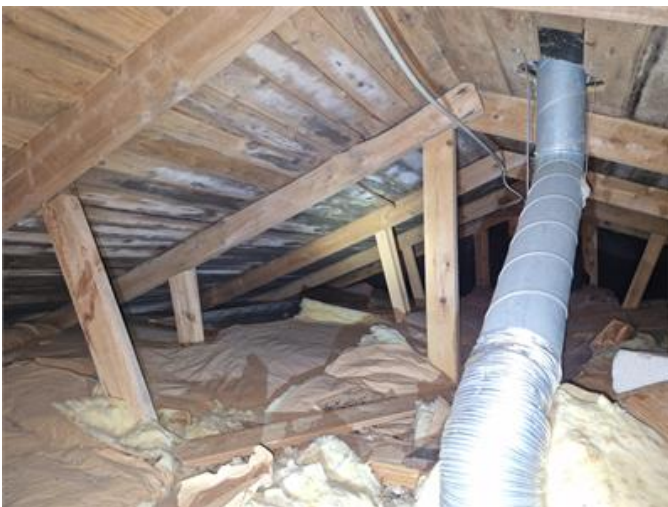
Nockvind mot väster, mikrobiell påväxt i underlagstaket, oisolerad imkanal som även har otät genomföringen i bjälklaget.
