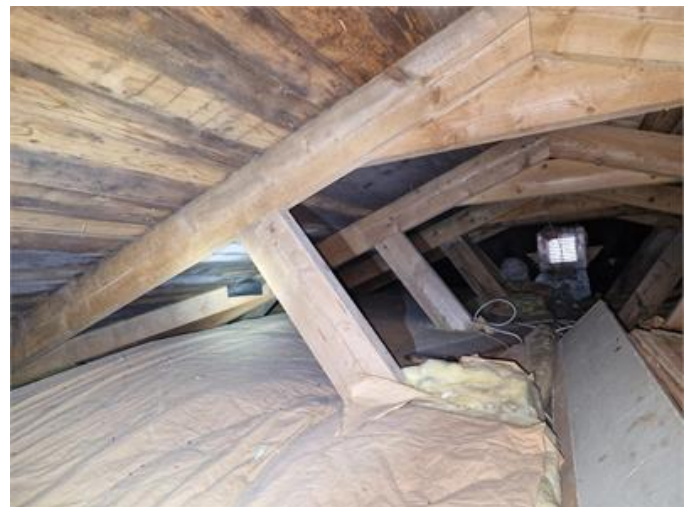
Nockvind mot öster, mikrobiell påväxt i underlagstaket.
