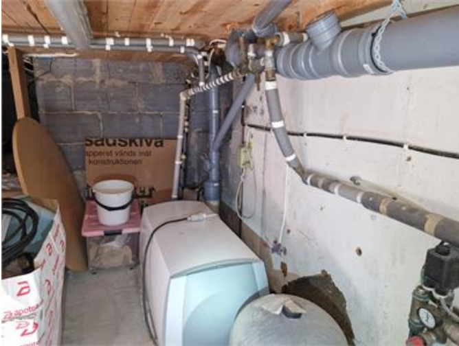
Grovkällare/Krypgrund ursprunglig del, äldre utreglad vägg bör avlägsnas.
