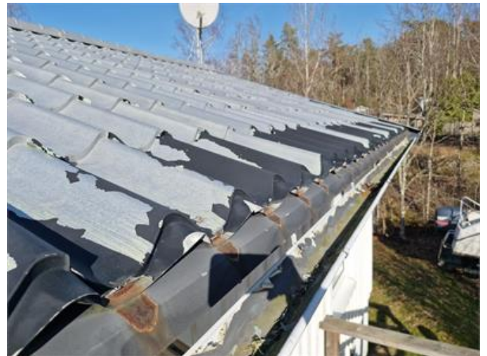
Tak, färgsläpp och rostangrepp.
