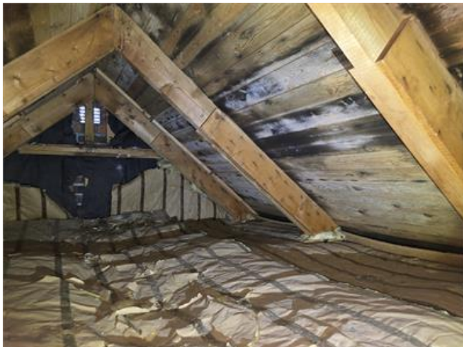
Nockvind: Mikrobiell påväxt/missfärgningar på underlagstak.
