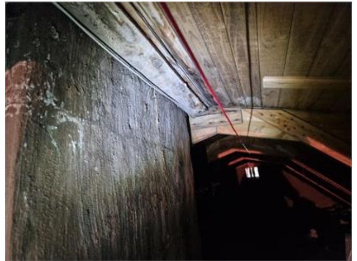
Fukt och mikrobiell påväxt på råspont/vind
