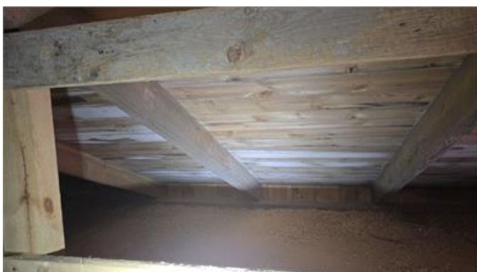
Exempelbild, mikrobiell påväxt på underlagstak, vind.
