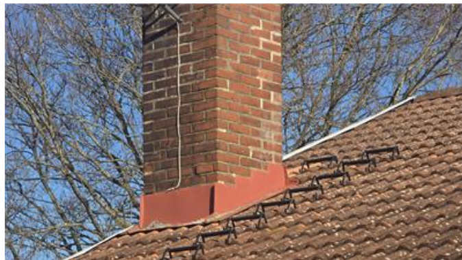
Översiktsbild murstock med mindre frysskador. Kan med fördel åtgärdas alternativt förse murstocken med plåtbeklädnad.
