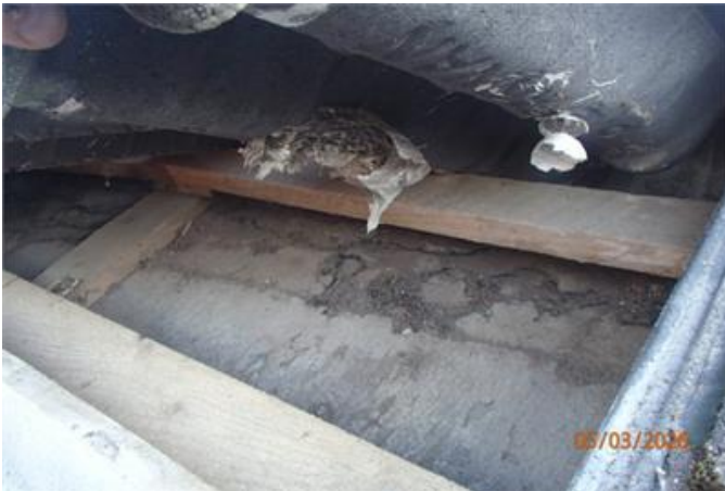
Bild tagen under panna på tak sidan där pappen inte är bytt.
