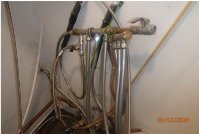
Bild på VVS installationer i teknik rummet. Bör ses över av behörig installatör.
