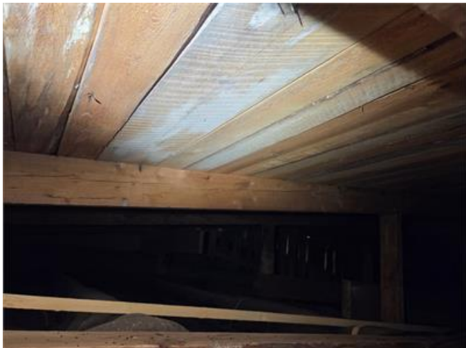
Mikrobiell påväxt på underlagstak.
