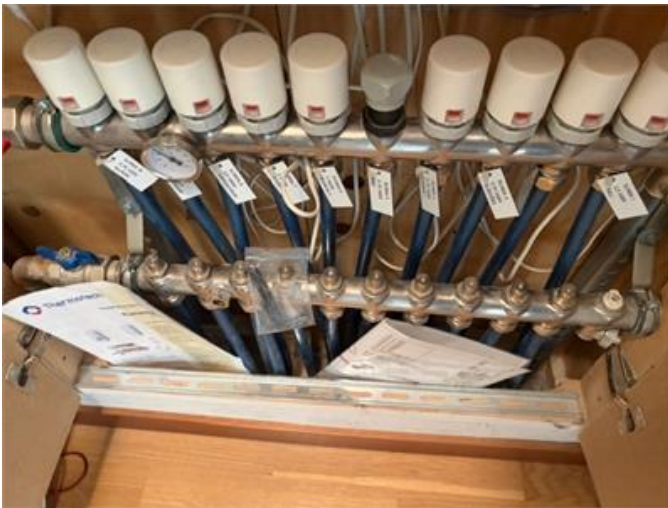
Rörsamlingar är inte monterade i fuktsäker låda med avrinning. Risken med det är att eventuella läckage kan leda till mer omfattande fuktskador. Vattenlarm kan med fördel monteras.
