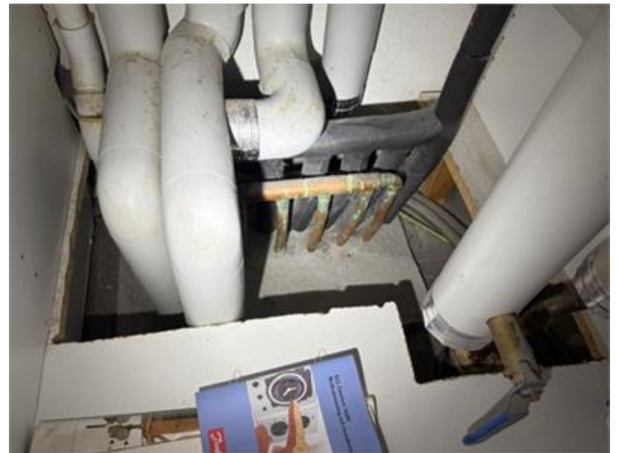
Rör genomföringar i golv förekommer vilket var godkänt enligt gällande branschregler när huset byggdes. Det förekommer rör genomföringar på gjuten klack utan tätskikt.
