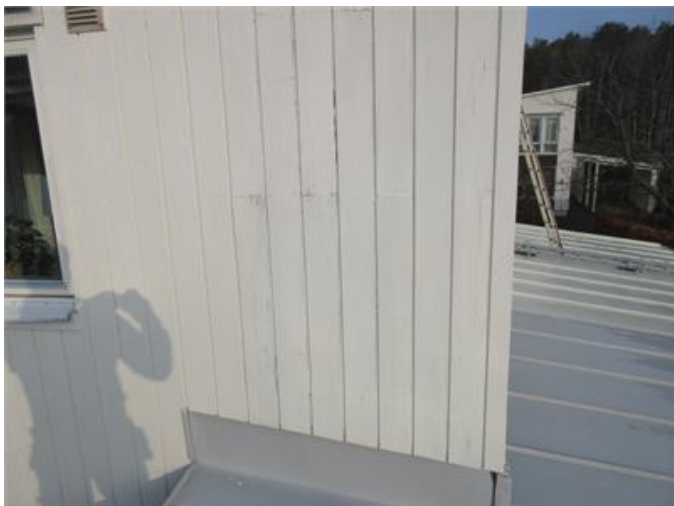
Bild visar torrsprickor/röta i fasadpanel
