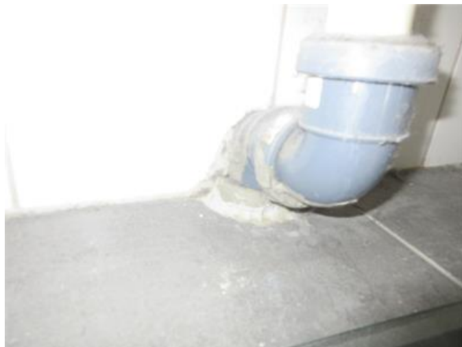
Tvättställsavlopp monterat nära vägg
