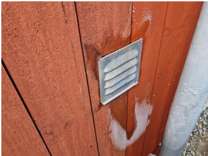
Fasad och Sockel: Fasadpanelen fuktig och frostbelagd i anslutning till frånluftsventil från krypgrund
