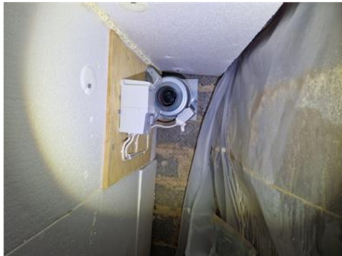
Krypgrund: Installerad frånluftsfläkt.
