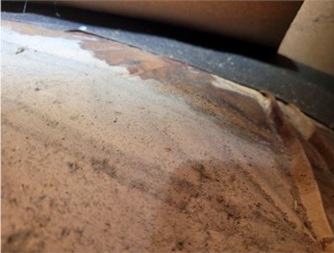
Fuktfläckar på isoleringsskivor
