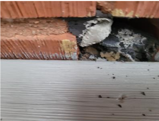
Otätheter mellan fasad och balkongens bärlina.
