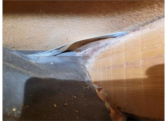
Mikrobiell påväxt och fuktfläckar på takstol & underlagstak
