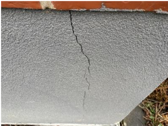
Bilden visar exempel på spricka i sockeln.
