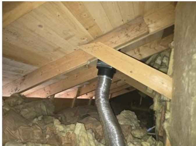
Im-kanal på vind.
