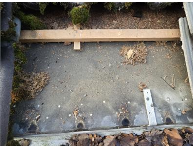
Tak: Stickprovskontroll under pannor, pannor direkt på plåt, rännkrok skruvad igenom papp med ökad risk för fuktrinträngning.
