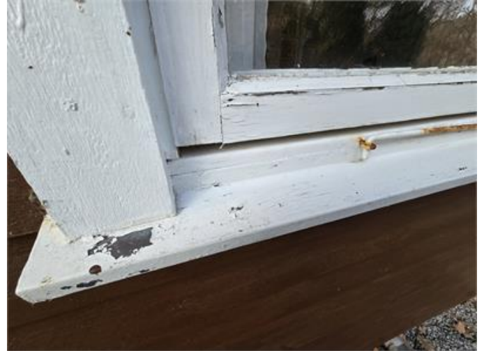
Fönster: Färgsläpp på plåt samt mindre underhåll som målning/kitta.
