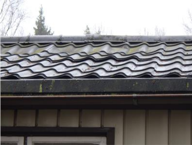
Deformation, glipor otätheter på taktäckning.
