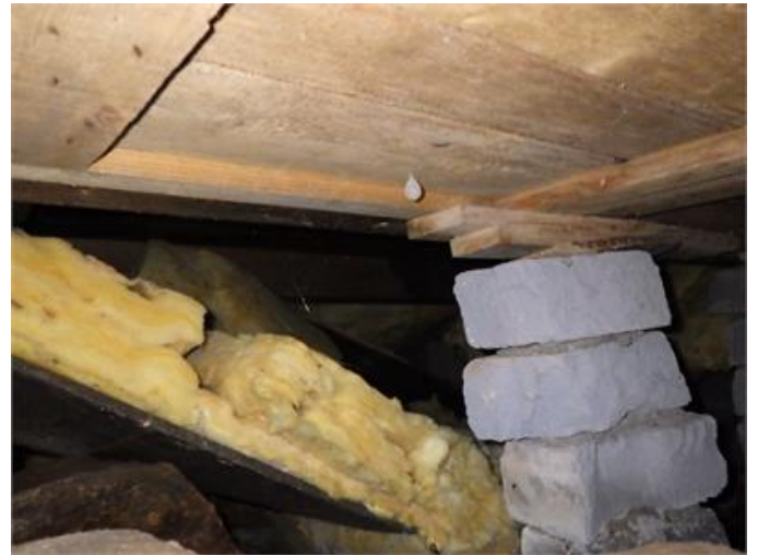
Delar av blindbotten som lossnat från bjälklag.
