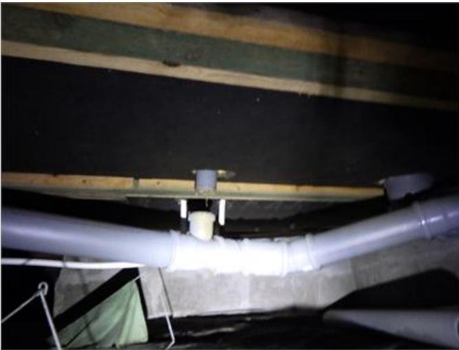
Bristfälligt klamrade installationer , avloppsrör som lossnat från avloppsstam.
