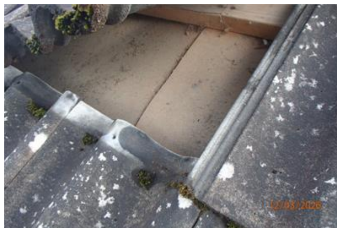
Bild på masoniten under takpannorna
