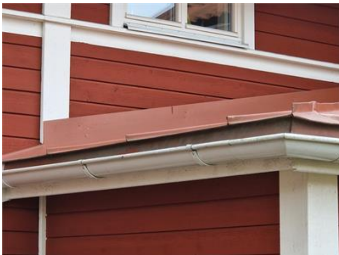
Tak: Uppvik på plåttak är delvis inte infräst i fasad.
