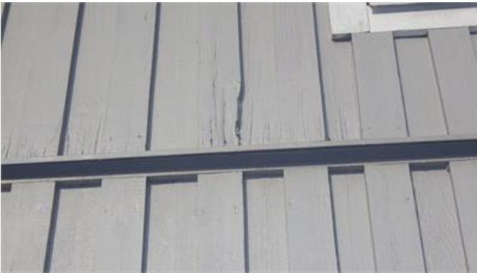
Rötskada i fasadpanelen
