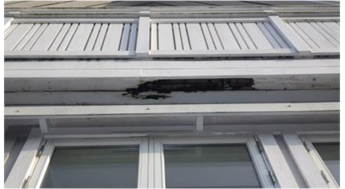
Rötskada i undersida balkong
