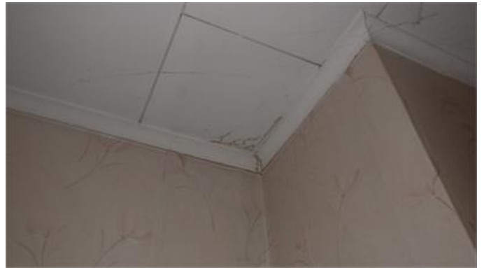
Fuktfläck i taket på övervåningen
