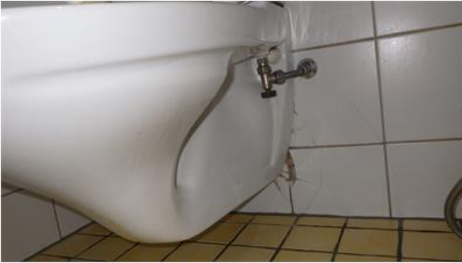
Bild där väggen bakom toalettstolen är trasig
