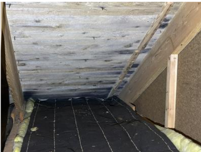
Nockvind: Mikrobiell påväxt förekommer på flera ställen.
