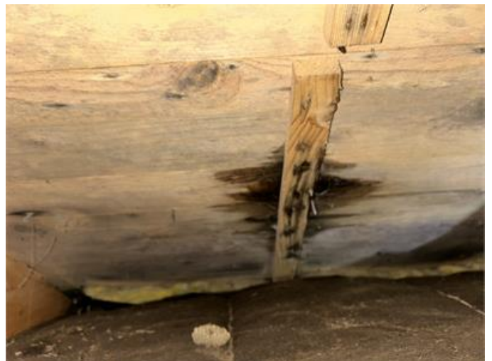
Nockvind: Fuktanvisningar med förhöjdavärden noterades.
