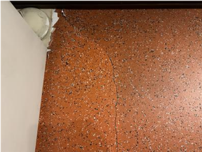
Källare: Sprickor förekommer i grundmur samt innerväggar.
