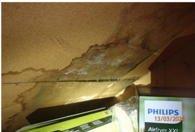
Äldre fuktskada noterades på sidovind.
