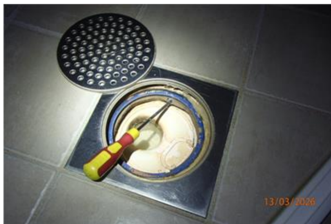
Golvbrunns manschett sticker ut under klämring.
