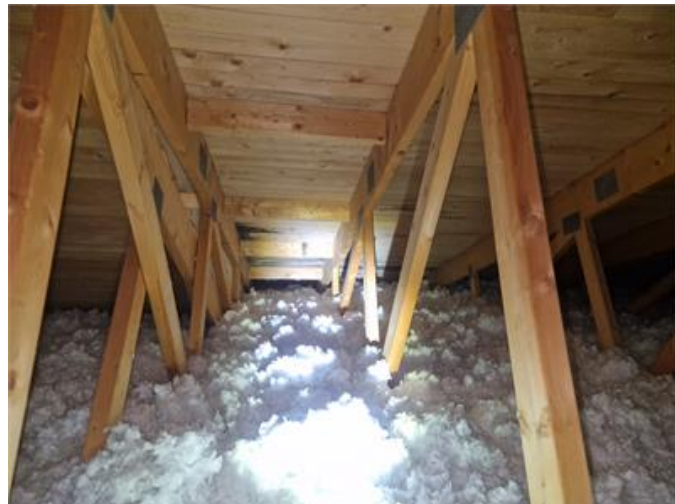
Missfärgningar på underlagstakets insida
