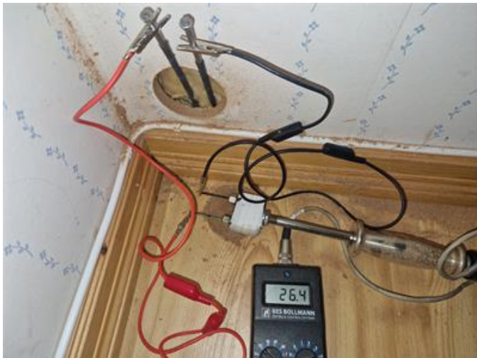
Fuktkvotsmätning i träregel i hobbyrum
