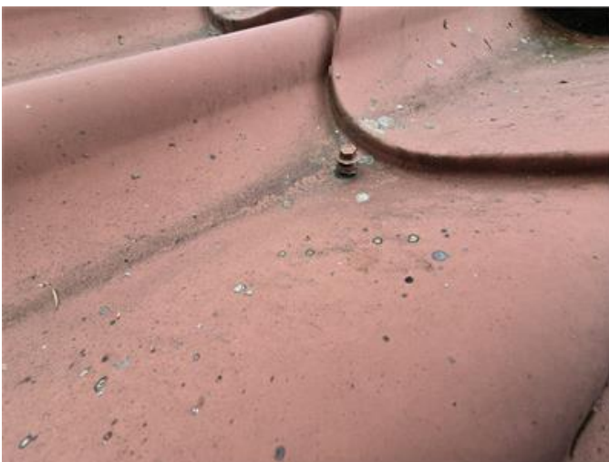
Tak: Infästningar har lokalt krypt upp från sitt rätta läge.
