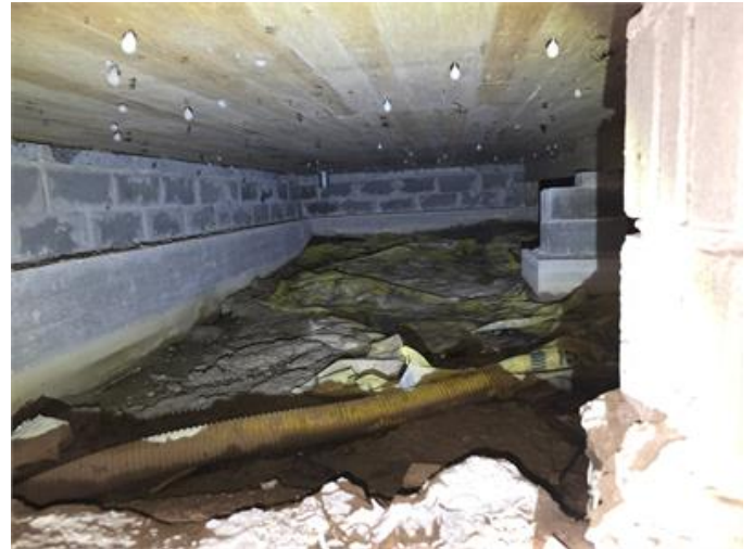
Krypgrund: Översiktsbild, plast ligger bristfälligt utlagd bitvis, fuktig miljö.
