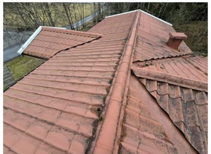
Tak: Översiktsbild, viss påväxt på plåt, skräp i rännor samt i rännor.
