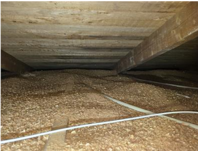
Nockvind: Översiktsbild, eldragning noteras ovan isolering, risk för kondens i rör. Underlagstak har mindre missfärgningar lokalt i nederkant.
