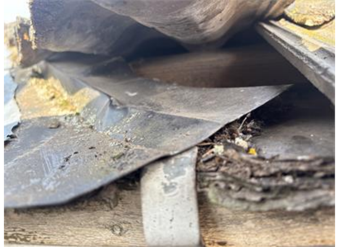
Skadat takunderlag samt bristfällig rännal
