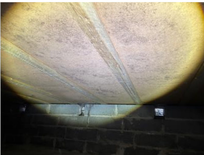
Missfärgningar, mikrobiell påväxt och träskyddsbehandlat virke i kryppgrund
