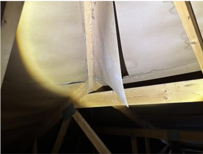
Hängande takunderlag samt fuktfläckar på vind
