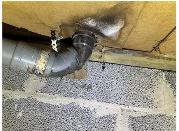
Fuktskadad trossbotten runt rör genomföring i kryppgrund
